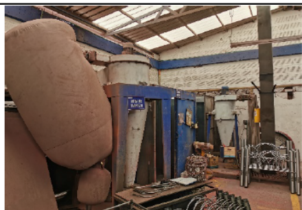
FOTO 3. CABINAS PINTURA, CICLÓN Y FILTRO
